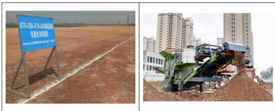
建筑废弃物路面
